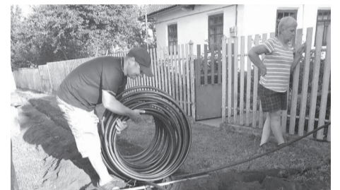
У селах Гринева (Віньковецька с.р) та Маломолинці (Лісовогринівецька ТГ) за фінансування ГК Енселко реалізовано проєкти по відновленню водопостачання.
